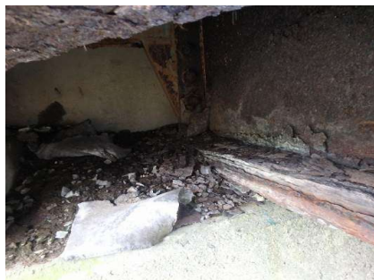
鋼橋の主桁の腐食
