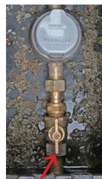
止水栓 (開いている状態)
