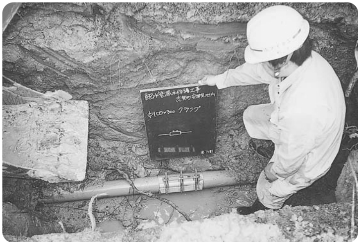
宅内での漏水では自己管理の責任を周知していく (写真は配水管漏水修繕)
