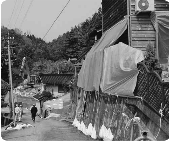
被災し全壊した家屋、基礎、よう壁が傾き危険と判定された住宅など被害が集中した鵜野屋地区
