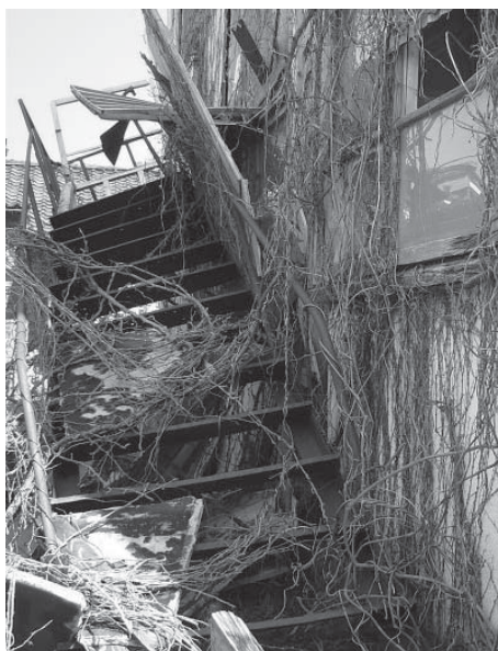
危険老朽家屋の背景には人口が減り空き家が増える事情がある。全国的には珍しいが解体処分費用の補助を始めた自治体もある。
