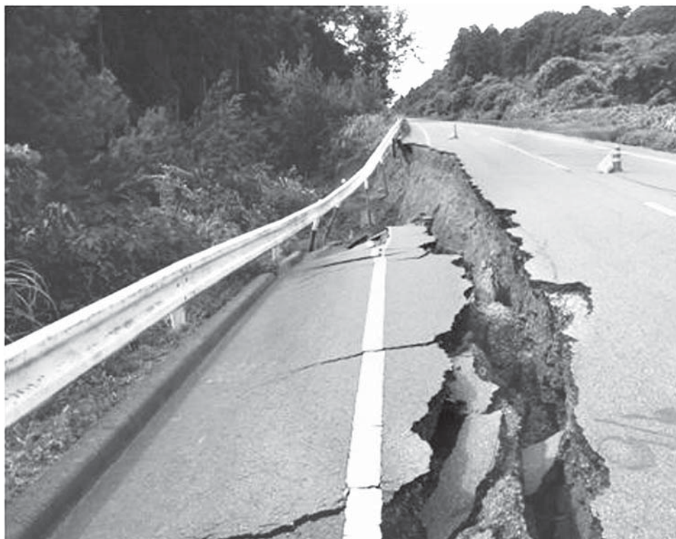
一日も早い災害復旧を（荒屋地内：ふるさと農道）
