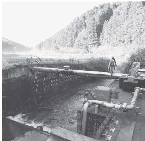
富来地域の生活を支える七海川水源地
