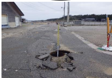
管損傷・滞留
